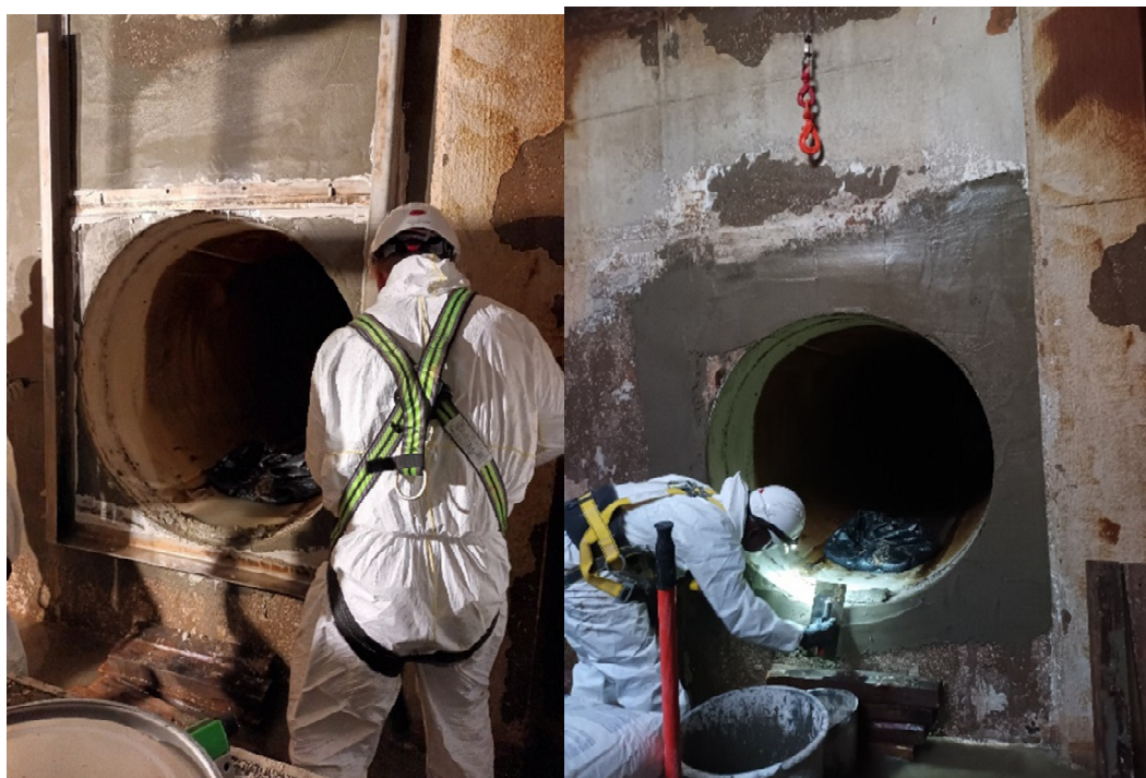
Figura 7 - Instalação de Comportas no interior das Cisternas de Água Tratada na ETA de Alcantarilha
