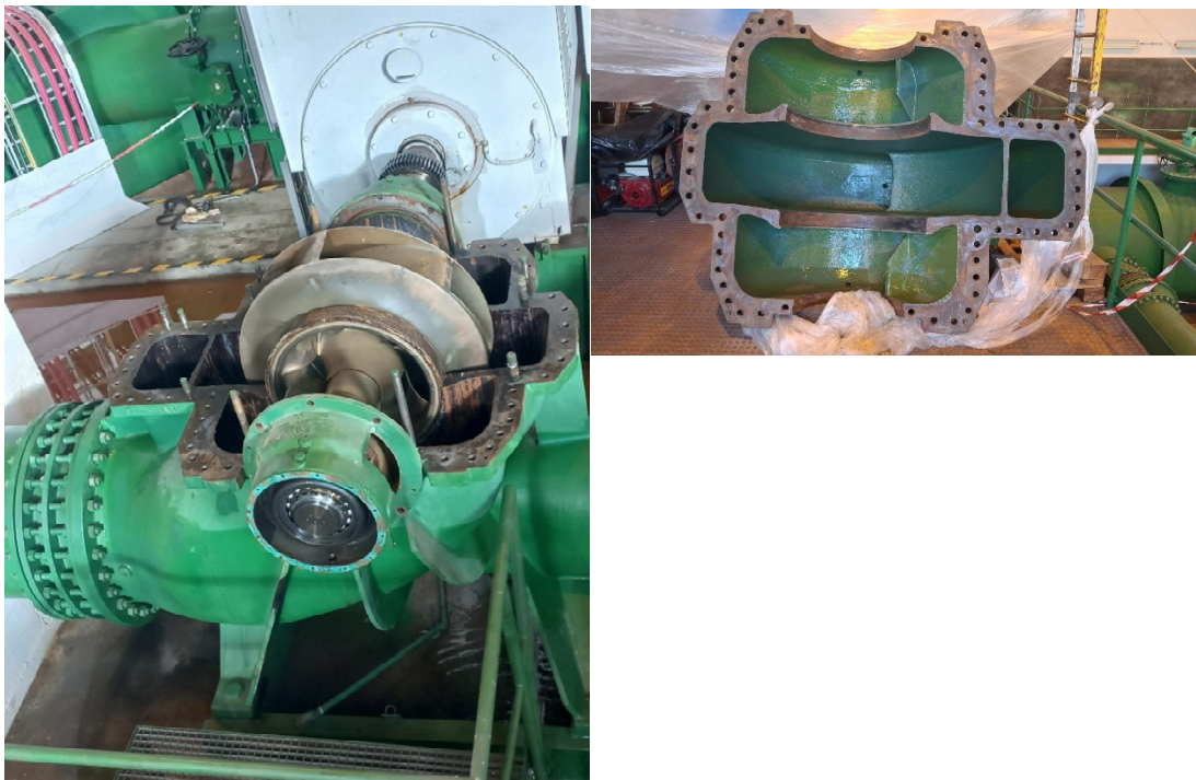
Figura 8 - Abertura, tratamento e revestimento interior e revisão geral de Bomba de 2.800 kW / 2,6 m 3 /s da E.E. I / A.H.O.B.
