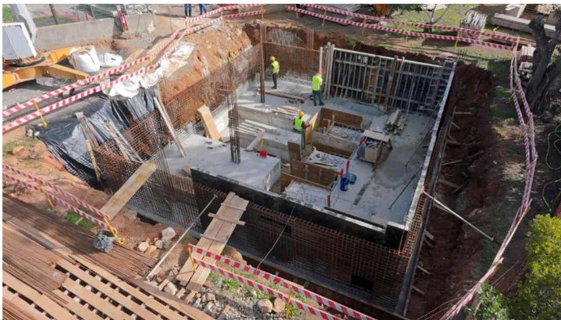
Figura 12 - Execução de Infraestruturas de Elevação e Adução ApR – ETAR de Almargem (PRR) – Trabalhos de montagem de armaduras e colocação de cofragem.
